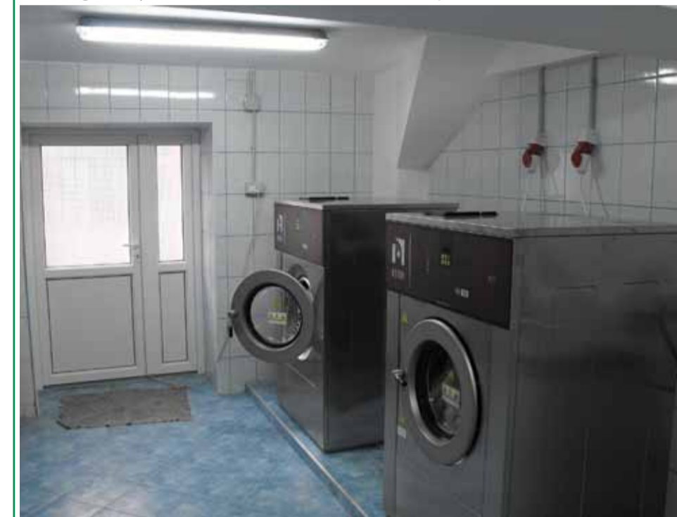
Spălătoria spitalului reabilitată, dotată cu mașini de spălat și uscător de rufe performante
