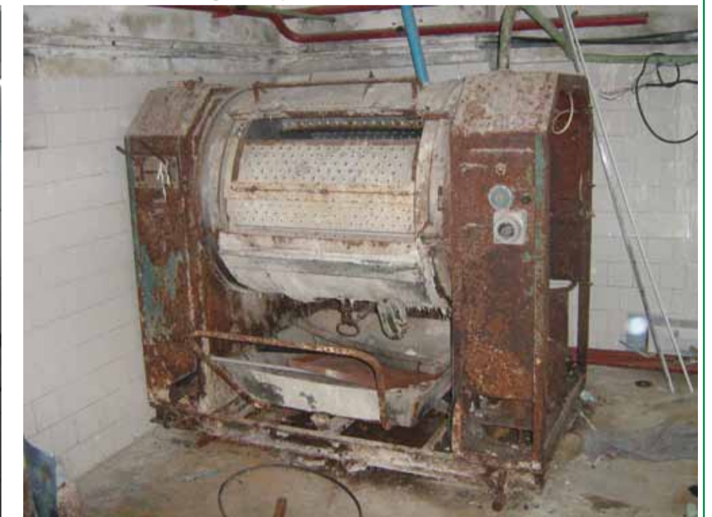
Spălătoria spitalului înainte de reabilitare, în stare avansată de degradare
